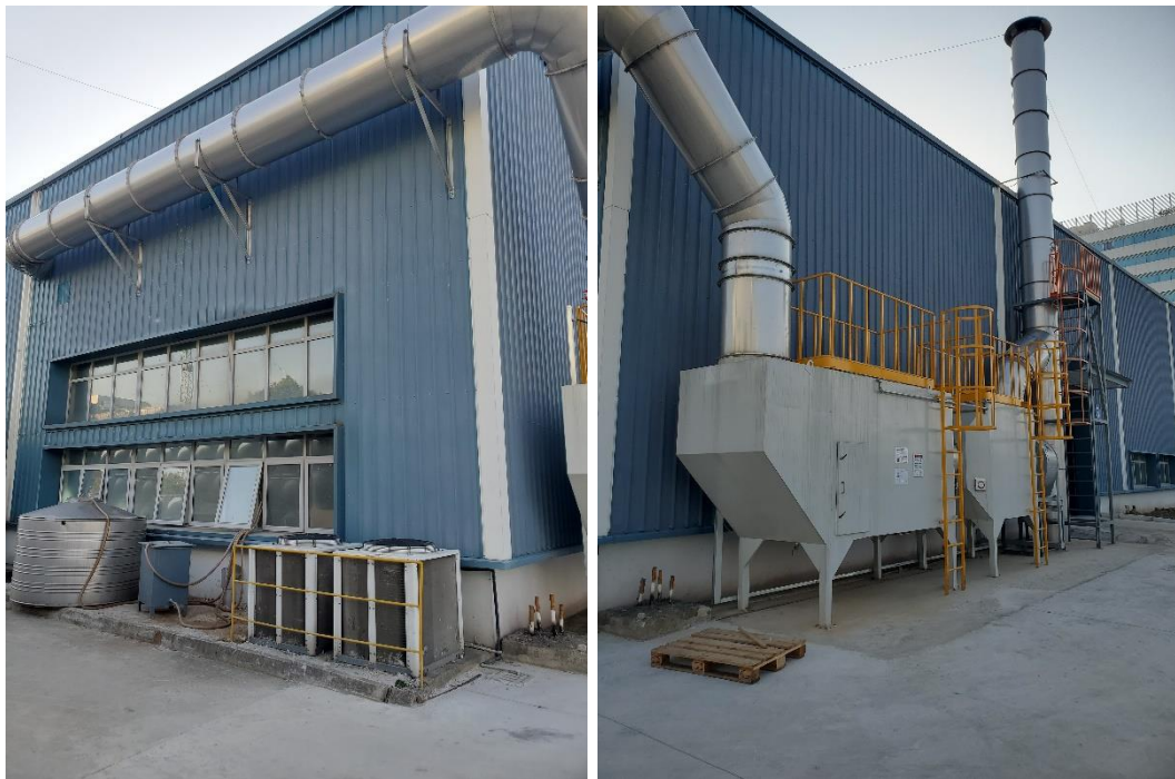
图 7-1 废气治理设施现场照片
