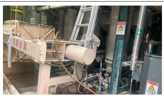
中水回用内部
